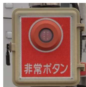
写真9 非常ボタンの例②
